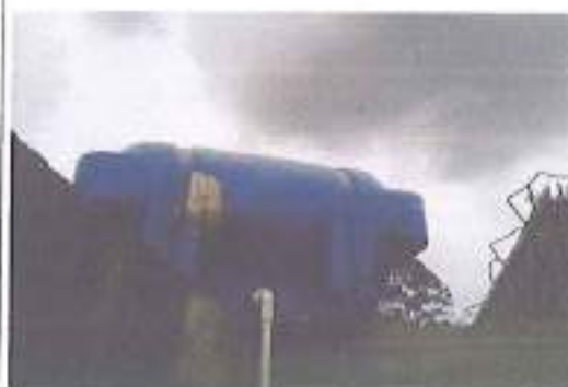
Tanque de abastecimiento de agua.
