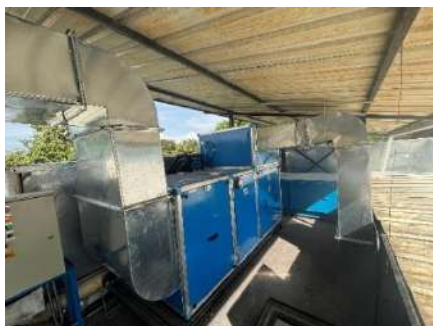
Nuevos equipos del sistema de ventilación mecánica de morgue principal
